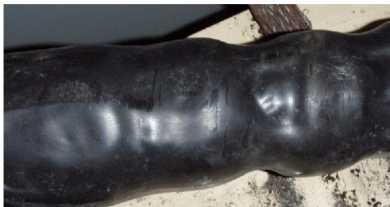
Pilt 5. Ebaühtlaselt kahandatud jätkumuhvi pind viitab võimalikele tihendusprobleemidele
