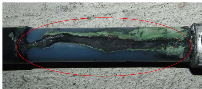
Pilt 1. Maa ja faasi vahelise isolatsioonipinna ülelöö, mida põhjustas muhvi sisse tunginud vesi
