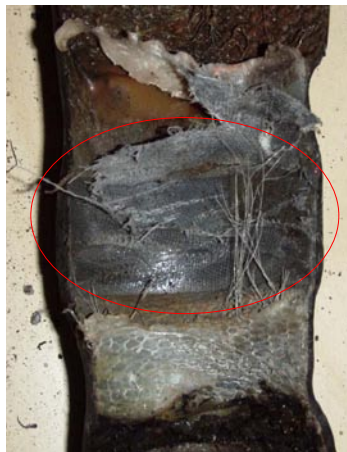
Pilt 2. Eirates paigaldusjuhendi nõudeid, oli montöör jätkumuhvi tihenduskohta katnud riidest lindiga, mis ei võimaldanud termokahaneval torul veetõket moodustada
