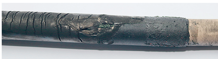
Isolatsioonirike 10 kV kummikaablis
