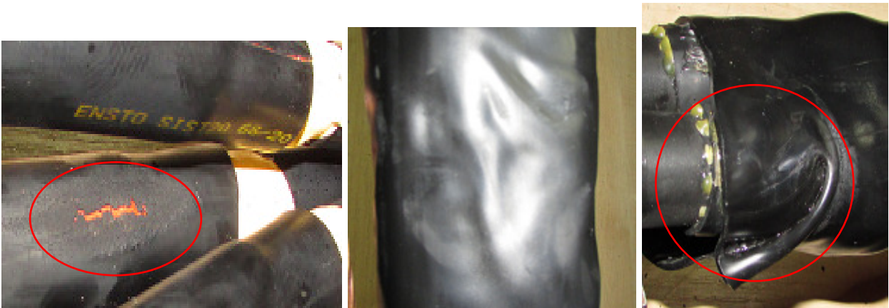
Pilt. 6. Termokahanevate materjalide kahandamisega seotud probleemid.
